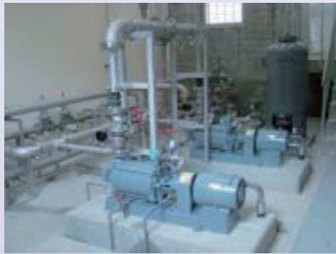
森ポンプ場・配水ポンプ
