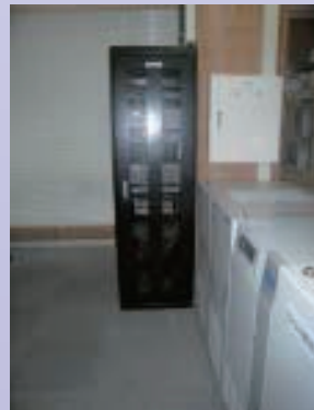
織田総合事務所内 サブヘッドエンド装置 ※各戸へCATV電波を送受信する装置
