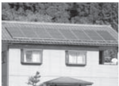
住宅屋根に設置された太陽光発電設備
