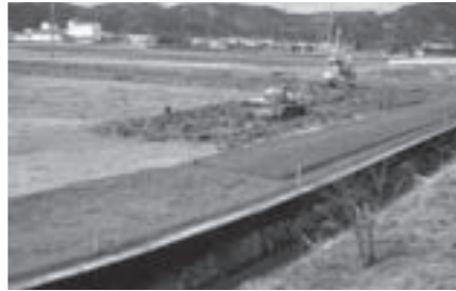
水量を適正に管理するための暗渠排水
