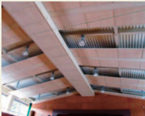
屋内運動場（体育館）の吊り照明（糸生小学校）
