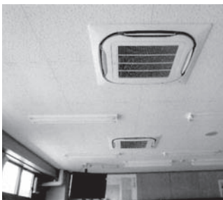
▲教室に設置されたエアコン（宮崎小学校）
