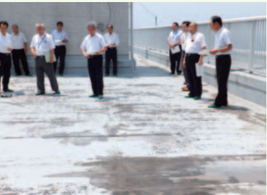
アクリル塗膜がはがれた四ヶ浦小学校屋上
