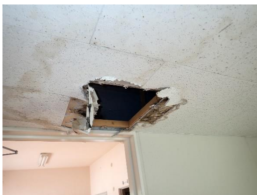
■スロープ 1階 天井雨漏れ・ボード破損
