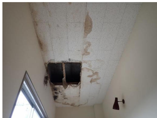
■階段 2階 天井雨漏れ・ボード破損
