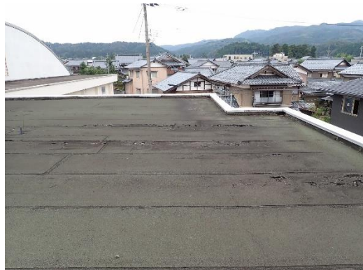
■屋根アスファルト露出防水の劣化
