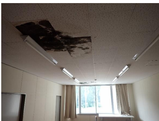
■会議室 2階 天井雨漏れ
