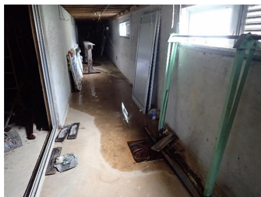
■ステージ下通路 水溜り発生
