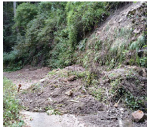
町道笹川1号線の崩土
