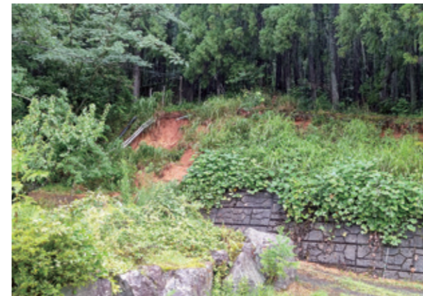
「陶寿園」土砂崩落により送水管破損
