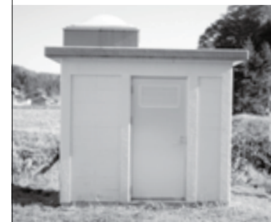
取水ポンプ室
