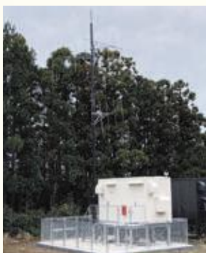
▲機器が更新された玉川中継局
