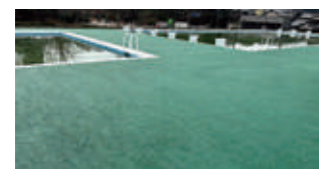
▲プールサイドが滑りにくくケガをしにくい床になりました
