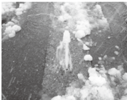
町道消雪設備
